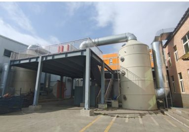
启润轮胎日照工厂废气处理设施
