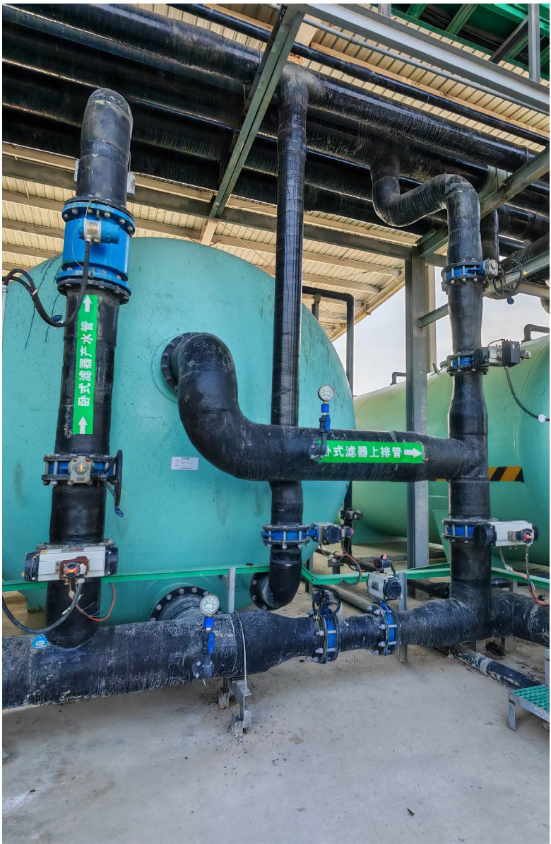
宁波振诚生产废水处理系统
