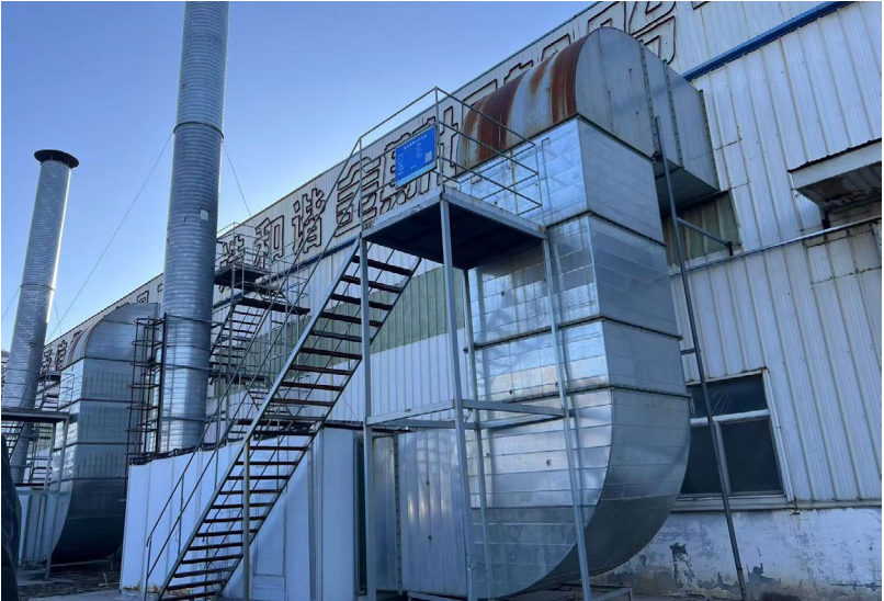
启润轮胎德州工厂废气处理设施
